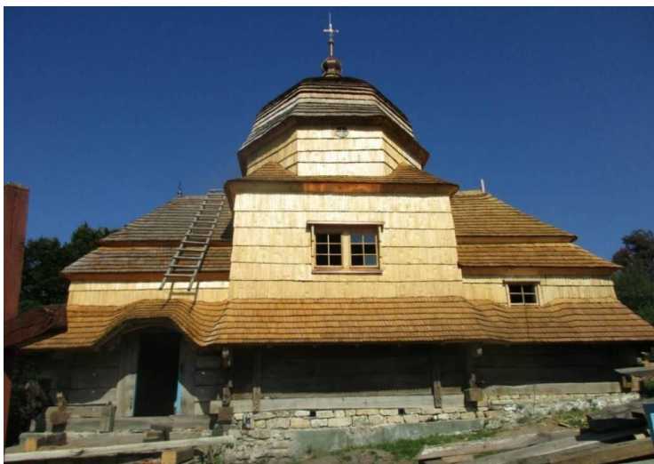
Łoni, cerkiew z 1724 r. w trakcie prac konserwatorskich, fot. W. Słobodian, 2019 r.
